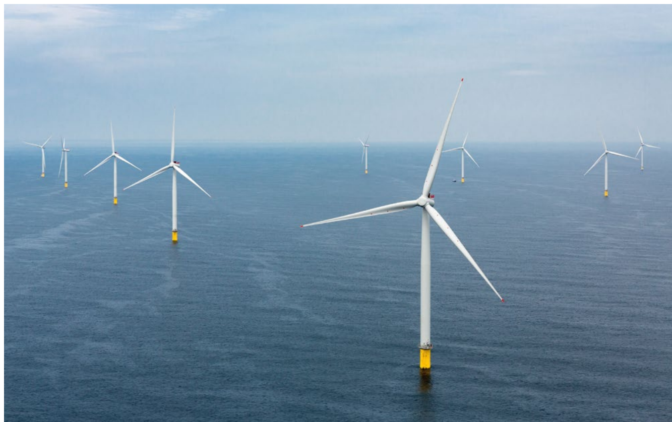
Ветряные электрогенераторы Siemens Gamesa
